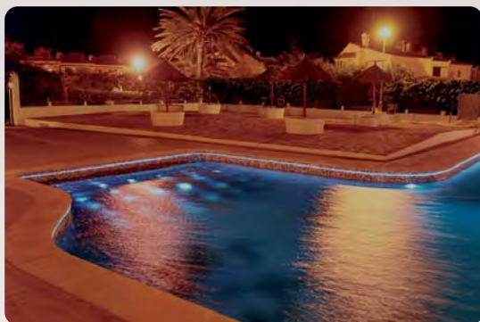
Piscina iluminada con fibra
